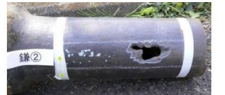
水道管(1935年布設)の腐食状況 出典:同審議会中間とりまとめ
